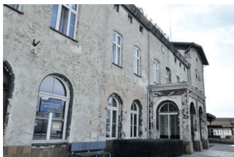
Aktualny stan dworca PKP w Oleśnicy
