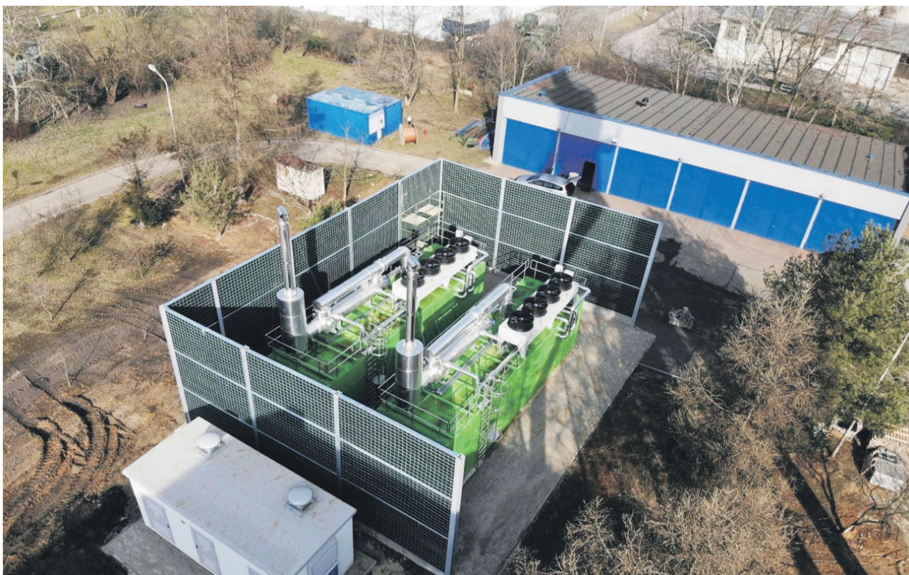
Instalacja wysokosprawnej kogeneracji gazowej przy ul. Ciepłej w Oleśnicy.
