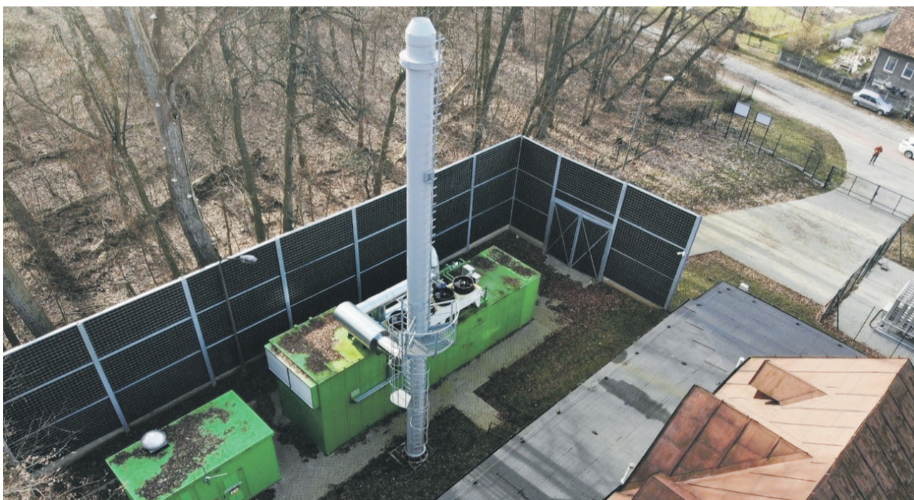
Instalacja wysokosprawnej kogeneracji gazowej przy ul. Brzozowej w Oleśnicy.
